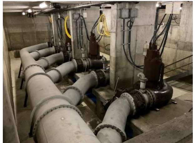
Pumpwerk mit 7 Pumpen und Entlastungskanal in Richtung Emme
